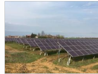
Italien Freifläche in Betrieb 2,8 MWp
